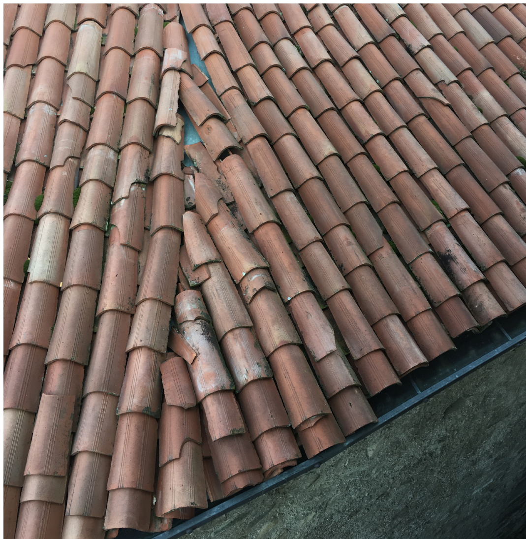
Dettaglio dello stato di degrado dei coppi
